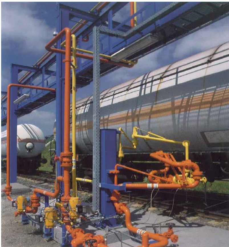
Abbildung 1: Eisenbahnkesselwagen – Entladeanlage Bernburg
